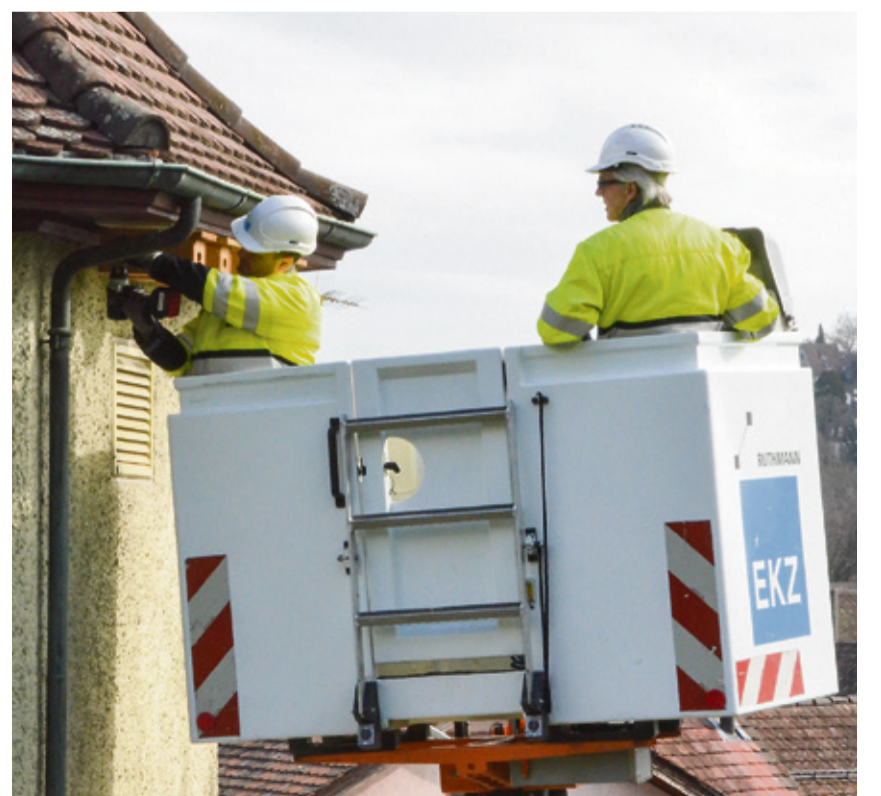
EKZ-Mitarbeiter haben am Mittwoch auf drei Seiten der Transformatorstation in Feuerthalen je fünf Nistkästen für Mauersegler angebracht. Bild: mra
